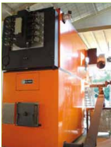
Chaudière bois 1,3 MW- Athis-Mons (91) Source : ARENE Ile de France – Philippe Salvi
